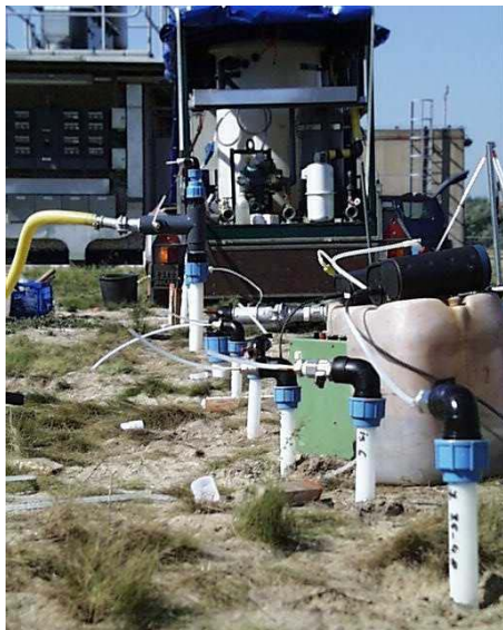
Foto: Proefopstelling bodemluchtextractiesysteem.
